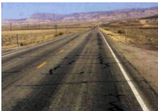
Рис.2. Усталостные и температурные трещины на дороге местного значения
